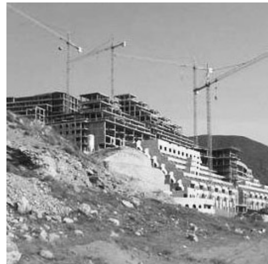
El Defensor del Pueblo abrió una investigación por la construcción de un hotel en la playa de El Algarrobo, dentro del Parque Natural del Cabo de Gata, en el dominio público marítimo-terrestre. La Junta de Andalucía decidió ordenar su derribo. Foto Los Verdes Indymedia.
